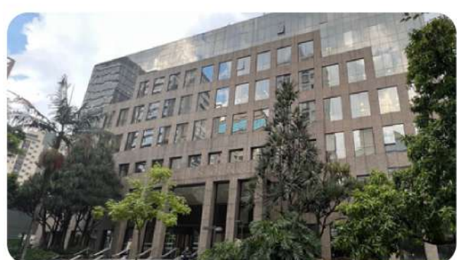
COND. ED. MADISON Inspeção umidade e estrutura
